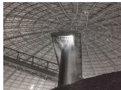
堆场喷雾系统
